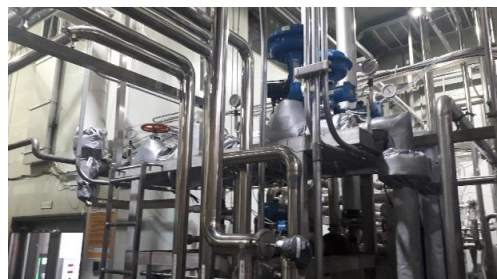
温水ユニット
