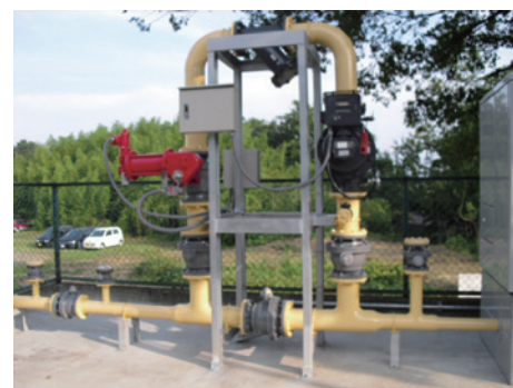
ガバナー設置状況
