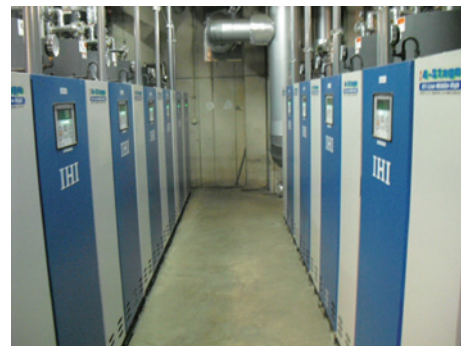
ガス炊きボイラー設置状況
