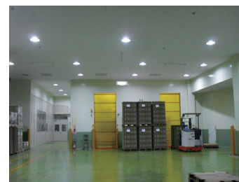
LED 照明設置状況（工場内）
