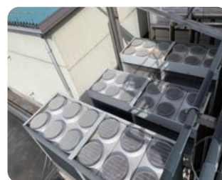
第3アイスビルダー冷凍機
