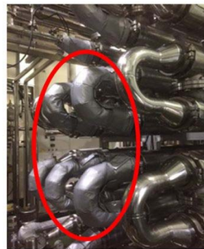
チューブ式殺菌機の配管 (タニガワプラント)
