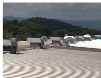
工場棟の屋根散水 (和歌山P)
